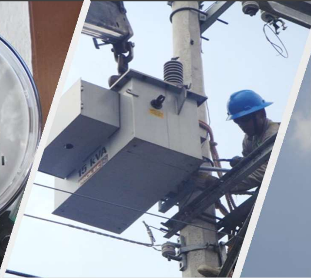
MVA DE TRANSFORMACIÓN
